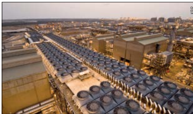
LNG train in Nigeria.
